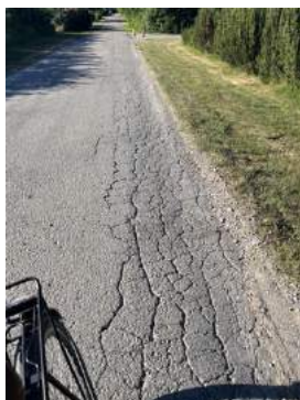
Krakelerede asfaltveje inden overfladebelægning
